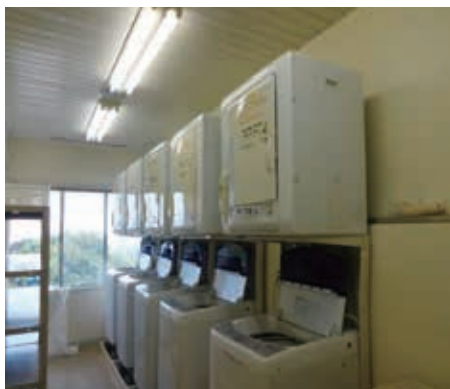
ランドリー室
